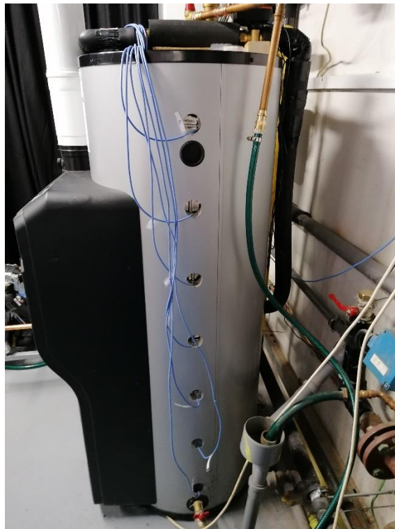
Obr. 6 Umístění povrchových čidel na zásobníku ohřivače vody
